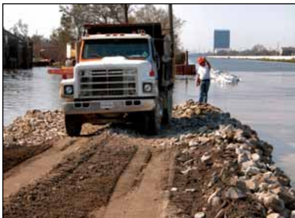
Foto: US Army Corps of Engineers Los diques de Nueva Orleans fallaron en 17 puntos.
